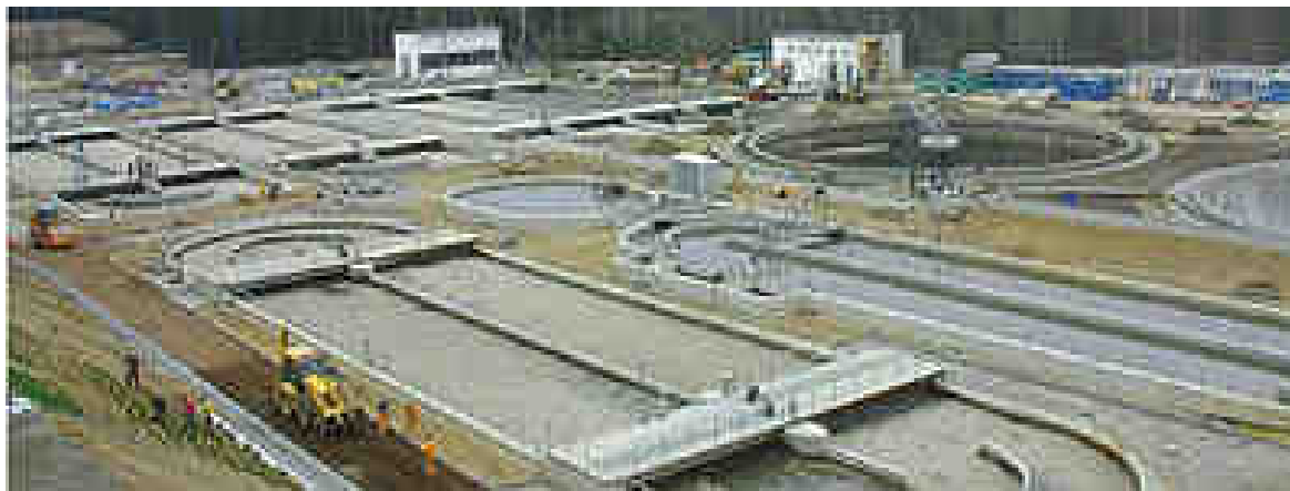
Zdjęcie 1. Oczyszczalnia ścieków „Łyna” w Olsztynie
