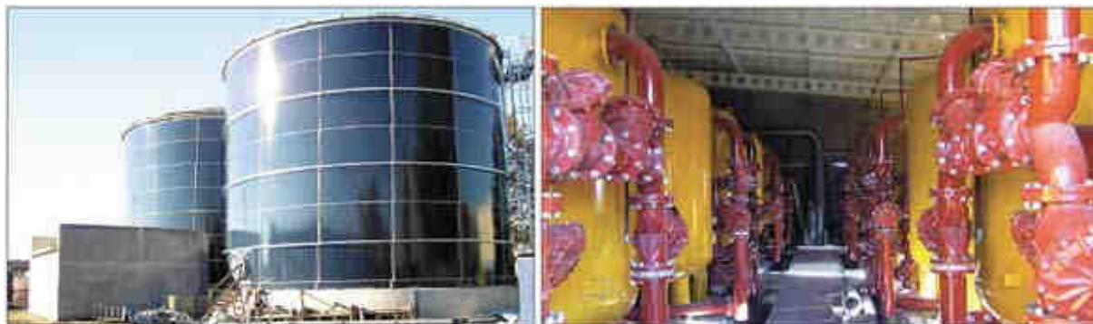
Zdjęcie 2. Stacja uzdatniania wody w Elblągu
